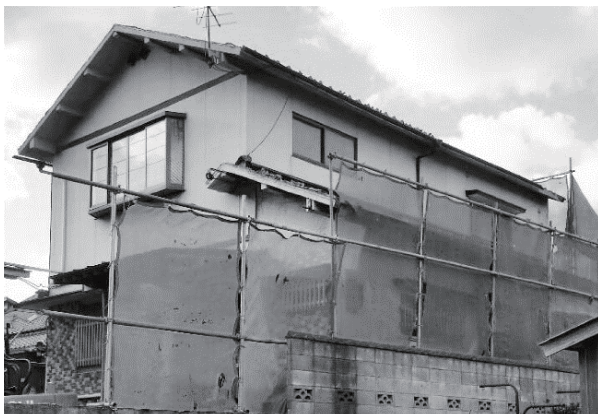
高さ不足、破れのある養生シート
